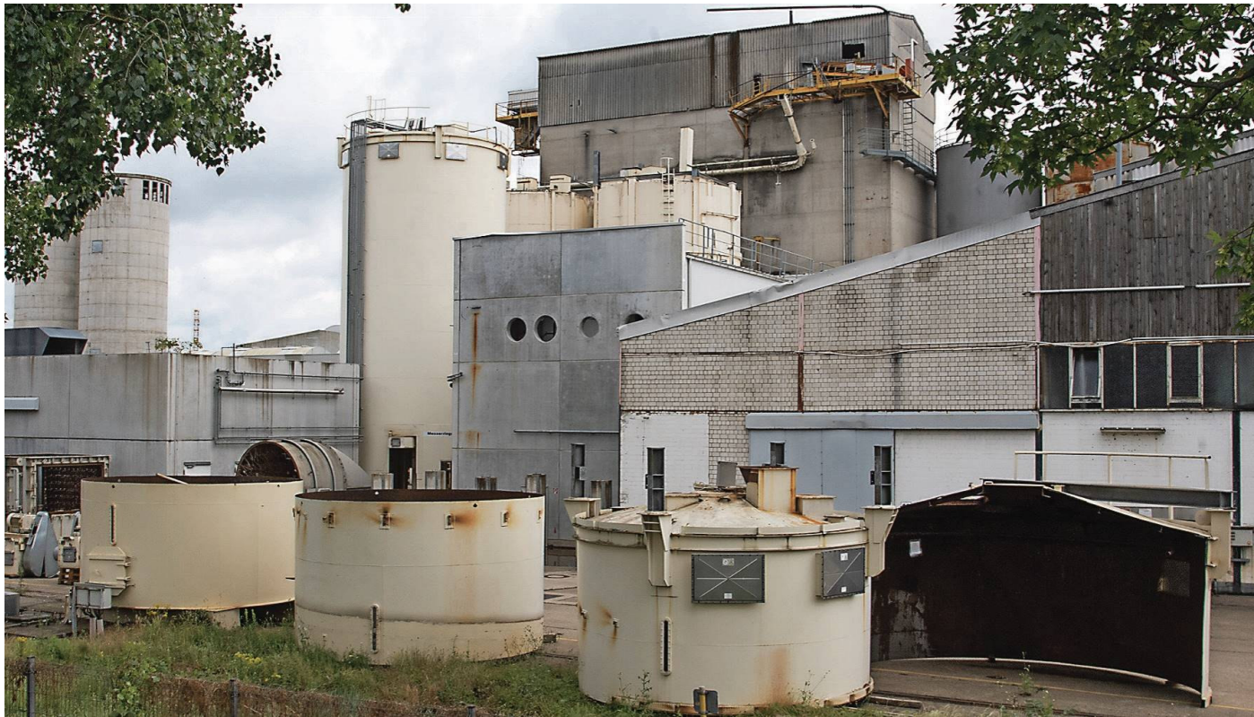
Die Anlage ist größtenteils demontiert und wartet auf den Abtransport. Foto: Vetter
